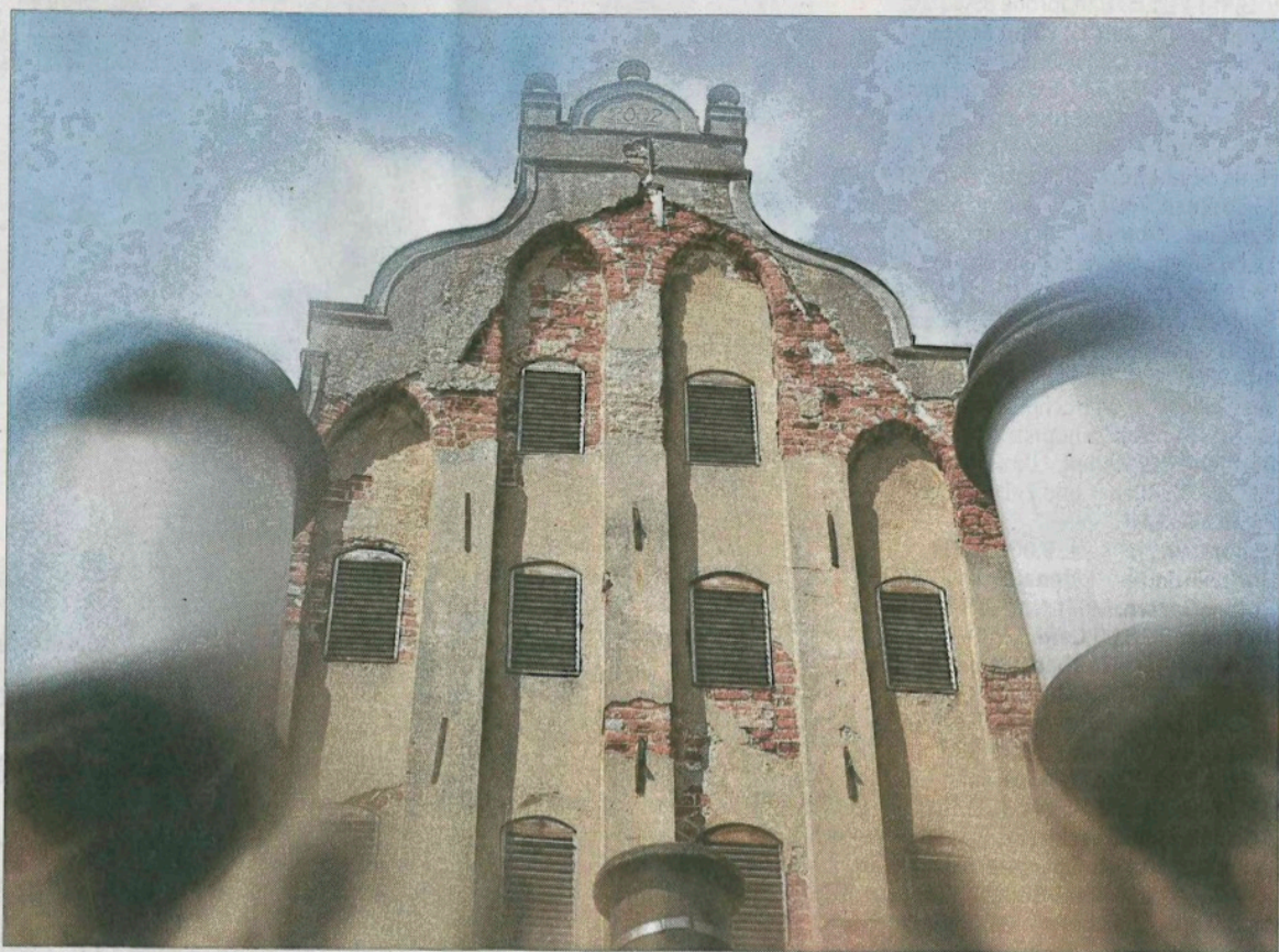
Das Haus Baderstraße 2 steht seit langem leer und verfällt, der Eigentümer kümmert sich nicht. Foto: Peter Binder
