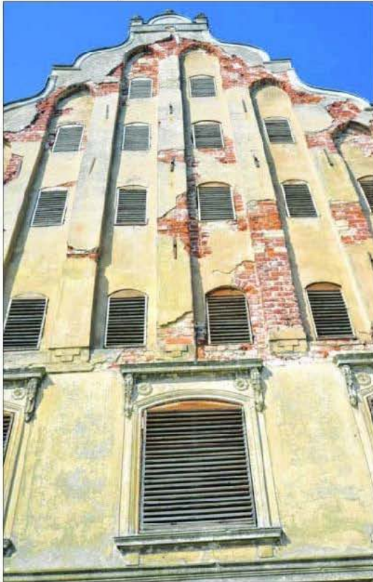
2003 sicherte die Stadt mit 188 000 Euro Städtebaufördermittel in die Baderstraße 2, ohne dass sich der Besitzer daran beteiligte. Foto: Peter Bänder
